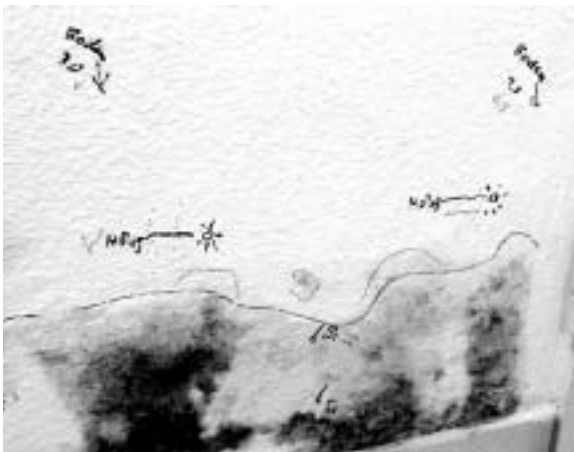
Abb. 26: Messpunkte und Feuchtehorizont
